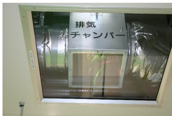
天井裏排気ダクトおよび風向・風量観察窓
